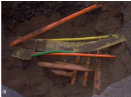
Figur 20. Viktigt att märka ut vilken ledning som är urinledningen. I detta fallet hade man förväxlat avloppsledningen och urinledningen, vilket resulterade i avloppsvatten i urintanken. (Foto: Michael Bernheden.)
