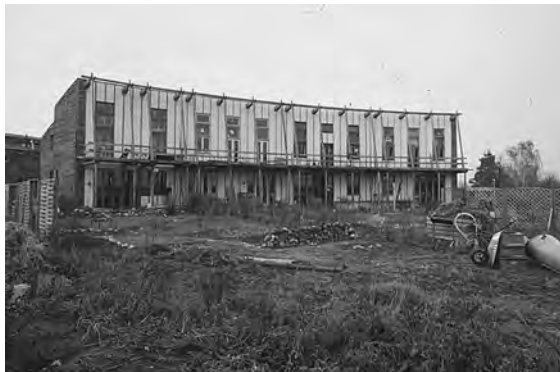
Fig 5.20. Ett av de fyra bågformade radhus i den tyska byn Schöneiche med bärande konstruktion av trä och innerväggar av lersten. Arkitekter: Schmidtman und Gölling.
