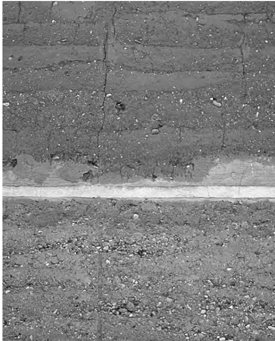
Fig 5.38. Till detta hus ville arkitekterna ha en slätare yta och lerjordsmassan modifierades därför med finkornig sand och tillsats av vatten. Detta visade sig vara ett misstag för väggen fick torksprickor och bebos numera också av solitära bin, som på sikt försvagar väggen.
