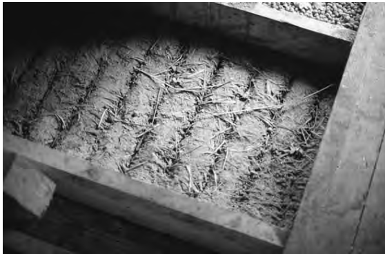
Fig 61. Vickler i ett golvbjälklag. När dessa torkat kan mellanrummet upp till bjälkens höjd fyllas med önskat tungt eller lätt material.
