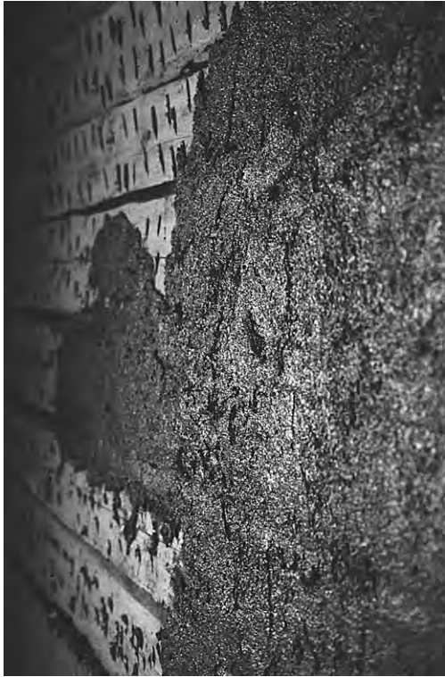
Fig 66. Första lagret puts på en liggtimmervägg som har skråhuggits för att ge putsen fäste. Gles väv av kokosfiber eller tunn vassmatta, som spikas fast, är att föredra då åverkan på väggen inte blir lika omfattande, men utgör ytterligare ett arbetsmoment och en utgift.
