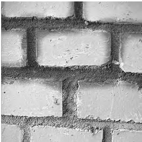
Fig 35. I bildens övre del har fogarna just snygats till några timmar efter det att stenarna murats, den nedre delen murades några dagar tidigare.
