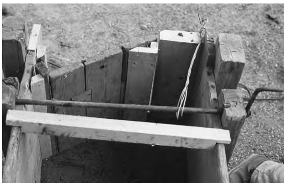
Fig 11. Horisontell formsättning vid utförande av en komplicerad hörnkonstruktion. Notera formstaket, som håller ihop formen, och distansen, som håller isär formsidorna.
