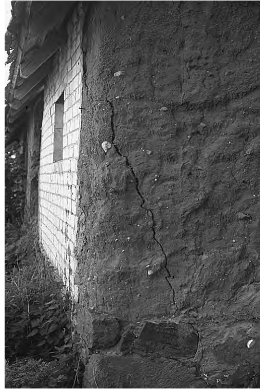
Fig 17. En mackelerad ekonomibyggning på landsbygden i Estland. Hörnet har inte klarat av den belastning det utsatts för, vilket med stor sannolikhet beror på dålig grundläggning.
