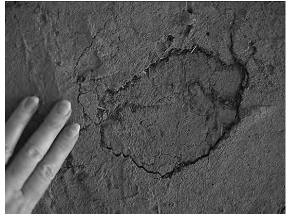
Fig 73. Puts är ett material som är ömtåligt för stötar och bör därför inte appliceras på ytor som är känsliga. Under denna lerputs består väggen av lerhalm, som kan vara något eftergivlig beroende på hur hårt den är packad.
