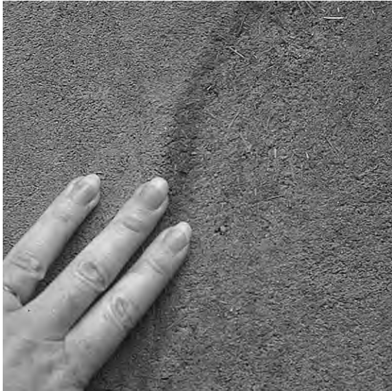
Fig 69. Här har en ilagning med den återanvända putsen gjorts där det blivit bom i putsen, dvs putsen har lossnat. När finputsens läggs på kommer detta inte att märkas.
