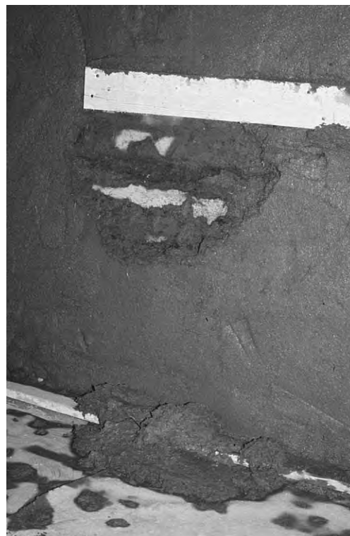
Fig 68. Grovputsen lades här på i för tjockt lager och lossade av sin egentyngd, men den nedfallna putsen kan läggas på igen.
