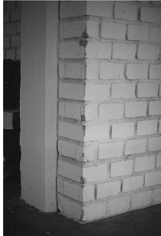
Fig 36. Kanter och hörn är känsliga partier i en byggnad. Muren har här målats med en silikatfärg som lätt kan släppa igenom fukt. Vill man ta vara på lerans fuktbuffrande förmåga i en innervägg måste målarfärgen kunna släppa igenom vattenånga. Färgen måste appliceras i minst 2 lager eftersom sten och fog suger olika mycket. Till ytterväggar av lera får, under några omständigheter, inte täta färger eller puts som innehåller cement användas.
