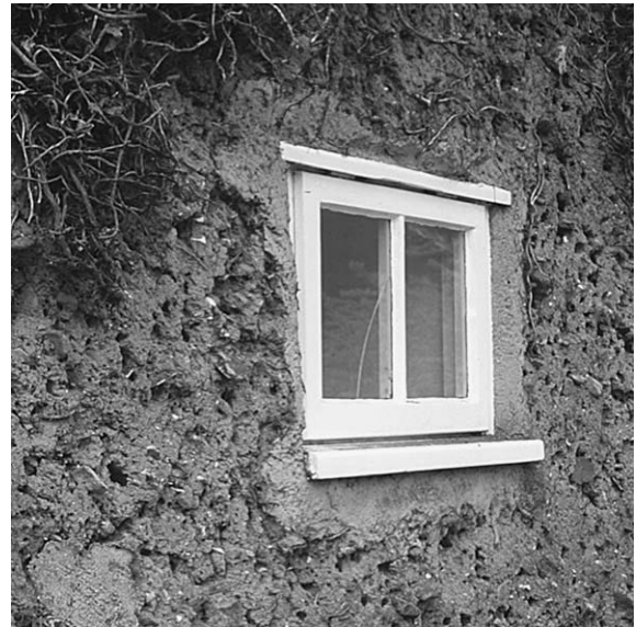
Fig 5. I denna mackelerade vägg har murens armerande halmstrån förmultnat och banat väg för bin som gräver gångar och trivs i dessa väggar.
