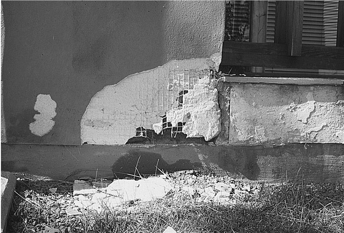
Fig 12. Från denna bild finns mycket att lära. Här möter två byggtekniker varandra. Den vänstra väggen består av lerhalsblock murade i lerbruk, den högra av en stampvägg. I skarven mellan de båda teknikerna rör sig materialen och sprickor uppstår. Muravkröningen leder vattnet rakt in i hörnan med lerhalm vilket fått till följd att putsen fryser loss, trots att ett armerande nät har spänts upp vid en av de många ilagningarna som måst göras under årens lopp.
