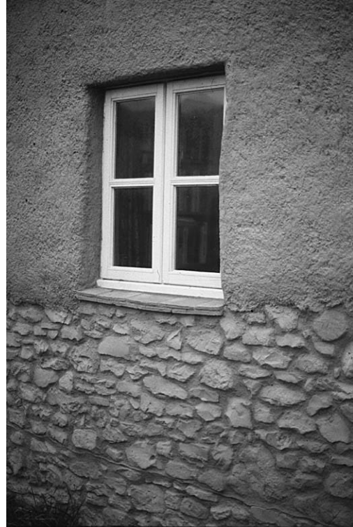
Fig 8. Denna fönsteröppning har utformats med en överdel som har en vinkel som fungerar som en droppnäsa vilket i viss mån hindrar att vatten kommer in i konstruktionen. Notera även fuktspärren i murens nedre tredjedel.
