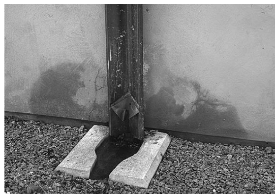
Fig 11. Vattenavrinningen fungerar inte tillfredsställande med denna lösning. Stänk från stupröret blåser mot väggen som riskerar att frysa sönder vid minusgrader.
