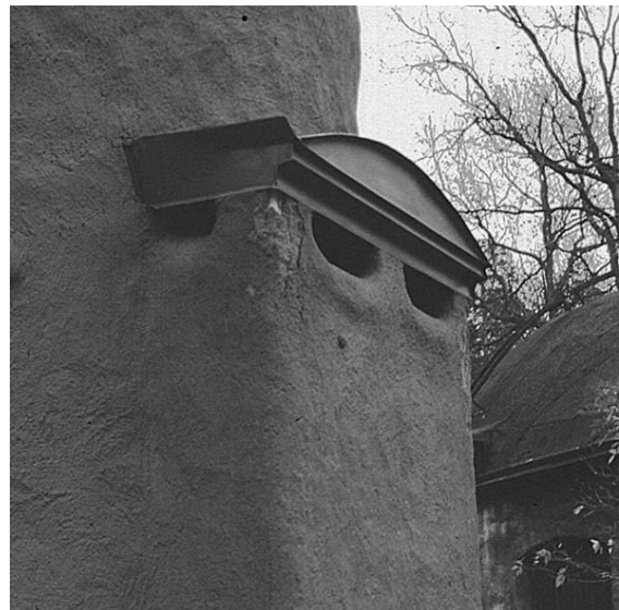
Fig 9. Det är viktigt att studera de byggnadsdetaljer som är mest utsatta för vädrets påverkan. Här har hörnen i det burspråksliknande ventilationsutsläppet skadats då täckning och avvattning inte varit tillräckligt väl genomtänkta - stuprör saknas.
