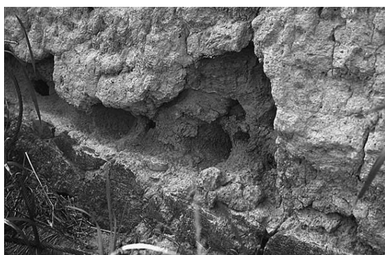
Fig 2. En ekonomibyggnad från förra sekelskiftet som inte har någon sockel utan står direkt på grundmuren. Regnvatten har stänkt upp mot väggen och orsakat omfattande erosionsskador.
