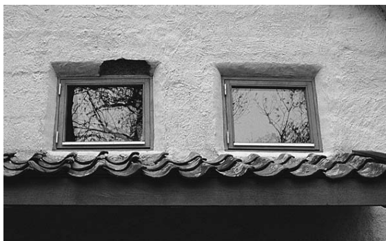
Fig 7. Här har vinkeln i fönsteröppningens överdel tydligen varit ogynnsam och vatten som runnit in i konstruktionen har frusit och sprängt sönder putsen.
